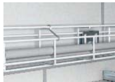
Предохранительный крюк в корректном положении
